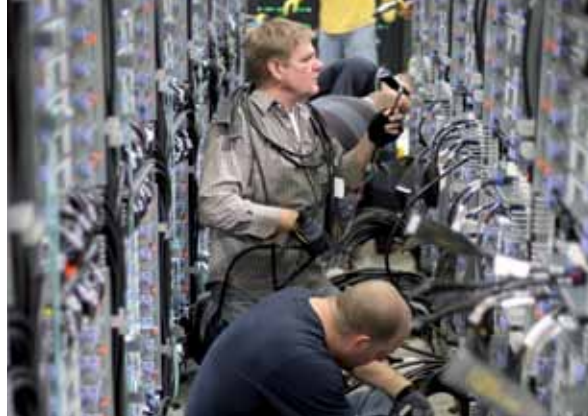
Die Leistungsfähigkeit von Höchstleistungsrechnern wächst rasant. Allein schon technisch gesehen stellt dies höchste Anforderungen an die Einrichtung und Wartung der Supercomputer, wie hier in Jülich.
