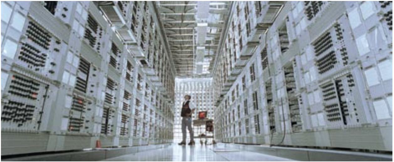
Schaltzentrum Deutsche Telekom AG. Kommunikationsknotenpunkte wie dieser benötigen besonderen Schutz.
