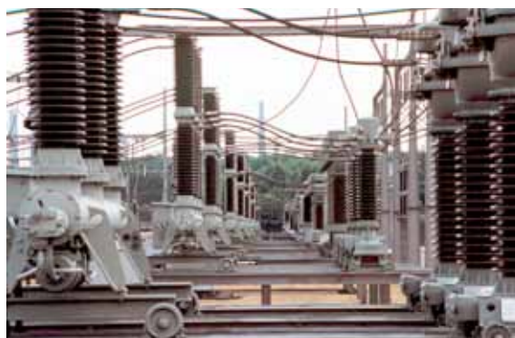
110-kV-Freiluftanlage (Quelle: RheinEnergie AG, Köln)
