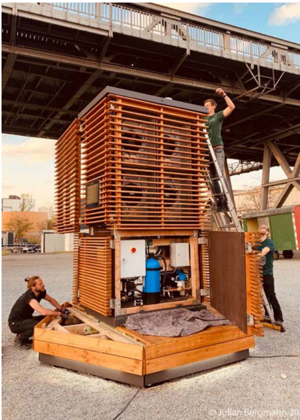
Am Gleisdreieck in Berlin wird ein City Tree aufgebaut: Vor dem Einsatz der Moosmatten ist sein aufwendiges technisches Innenleben noch sichtbar.
