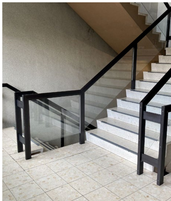
Eine alltägliche Barriere: das Treppenhaus eines Universitätsgebäudes
