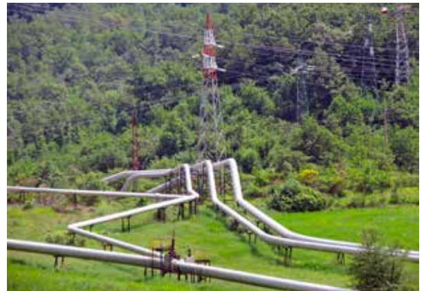
Oberirdisch verlegte Rohre eines Gasnetzes (Quelle: © svidtoll – Fotolia.de)
